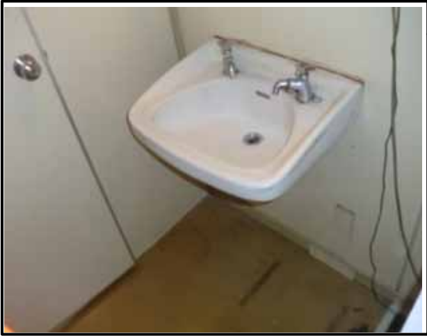
洗面台下開口部状況
